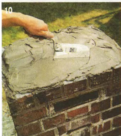
10 Раствор наносят с помощью кельмы и равномерно распределяют по поверхности кладки. Толщина слоя раствора — 2 см.
