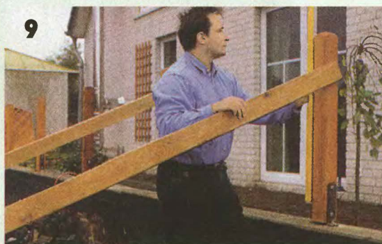
9 Важно правильно установить столбы — их выверяют с помощью шнура. Дальше работа пойдет легче.
