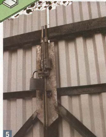
Верхние задвижки, закрытые на навесной замок.
